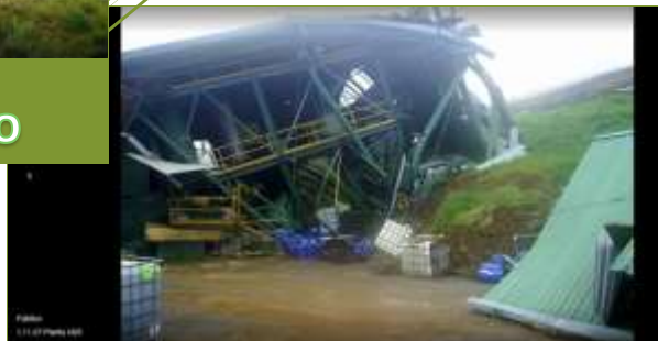
Después del Colapso
